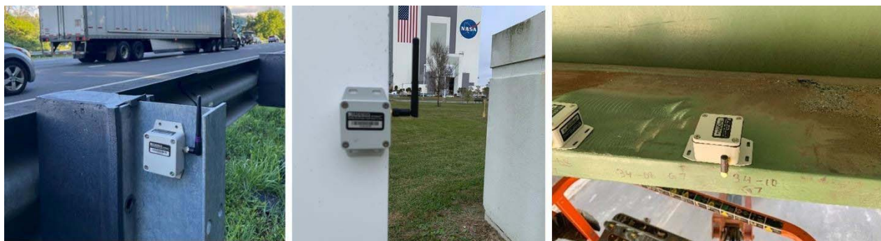
Slika 4: SenSpot™ senzori Resensys akcelerometra visokih performansi (HPA) instalirani na infrastrukturi
