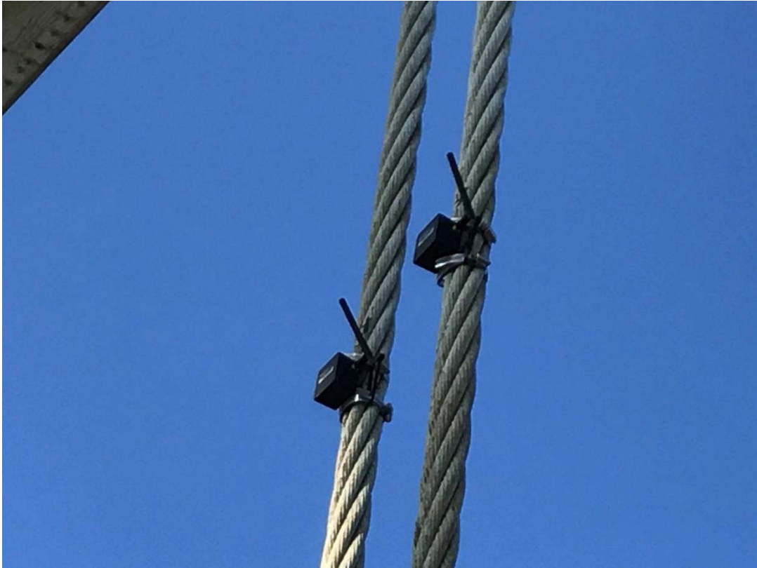
Slika 5: Resensys akcelrometar visokih performansi (HPA) SenSpot™ instaliran na kablovima visećeg mosta
