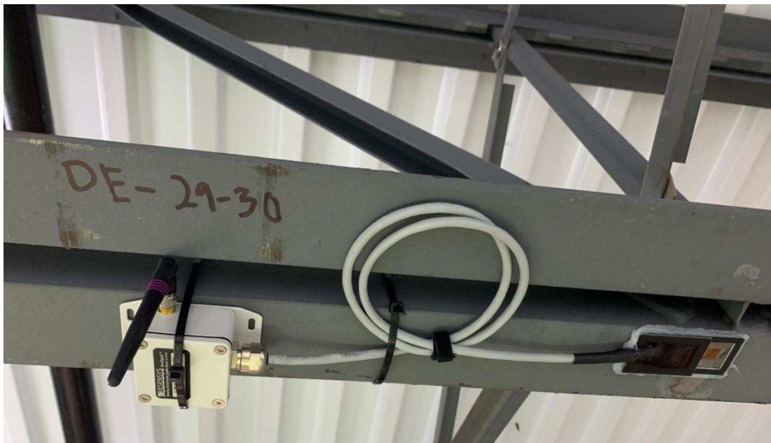
Slika 6: Instalirani merač naprezanja na krovnoj gredi (za praćenje opterećenja krova od snega)
