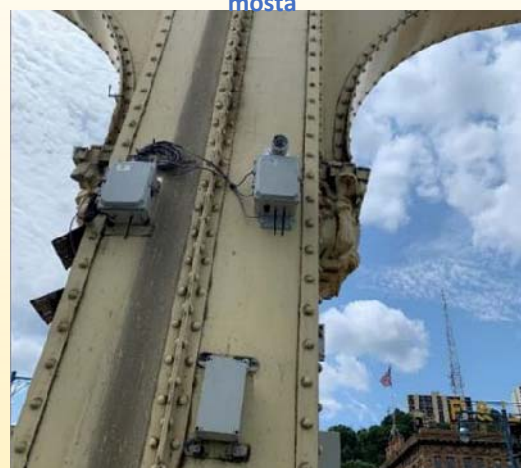
Bežična solarna kamera instalirana na stubu mosta da obezbedi potpune vizuelne povratne informacije o opterećenjima prekomerne težine
