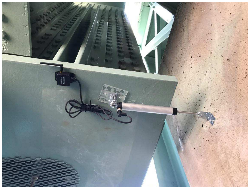
Slika 5: Instaliran merač pomaka SenSpot™ na mostu za merenje horizontalnog pomaka između stuba i nosača
